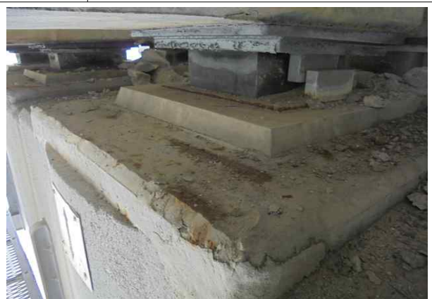
손상현황 • P6 코핑부 철근노출 원 인 • 시공미흡, 피복부족 조치방안 • 단면보수
