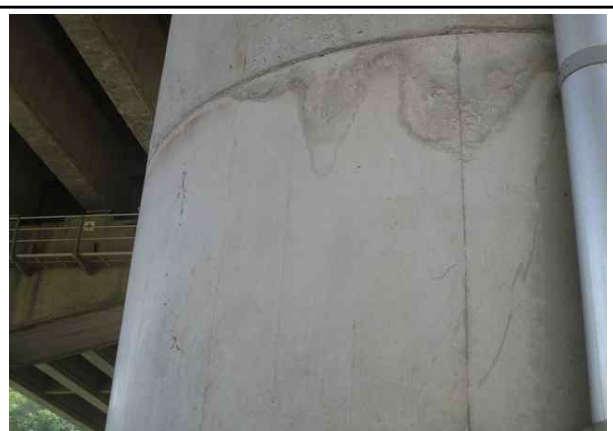
손상현황 • P2 기둥부 망상균열(1.0×1.0) 원 인 • 거푸집 조기탈형, 우수침투 조치방안 • 표면처리
