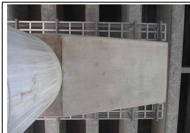
손상현황 • P1 코핑부 잡철 노출 원 인 • 시공미흡, 피복부족 조치방안 • 단면보수
